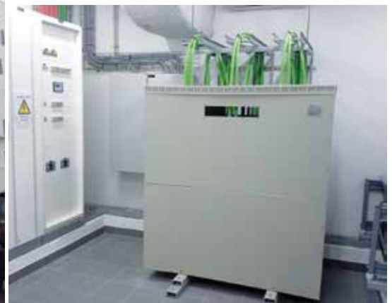
V.li.: Niederspannungs-Schaltschrank mit Bender-Geräten und dem 630 kVA 400/400 V-IT-System-Trenntransformator
