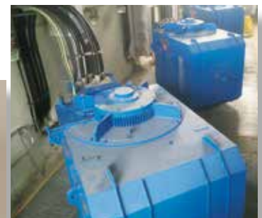
1200 PS Motor der Zulaufpumpen
