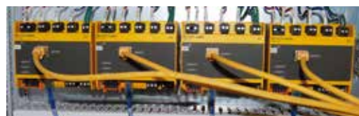
Isolationsüberwachungsgeräte des Typs iso685-S-B
