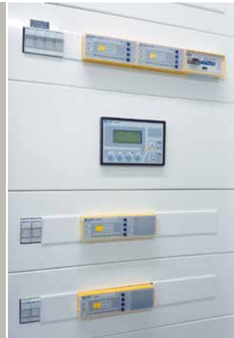
Niederspannungs-Schaltschrank mit Bender-Geräten
