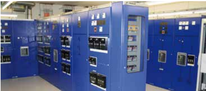
Elektrische Installation der NürnbergMesse
